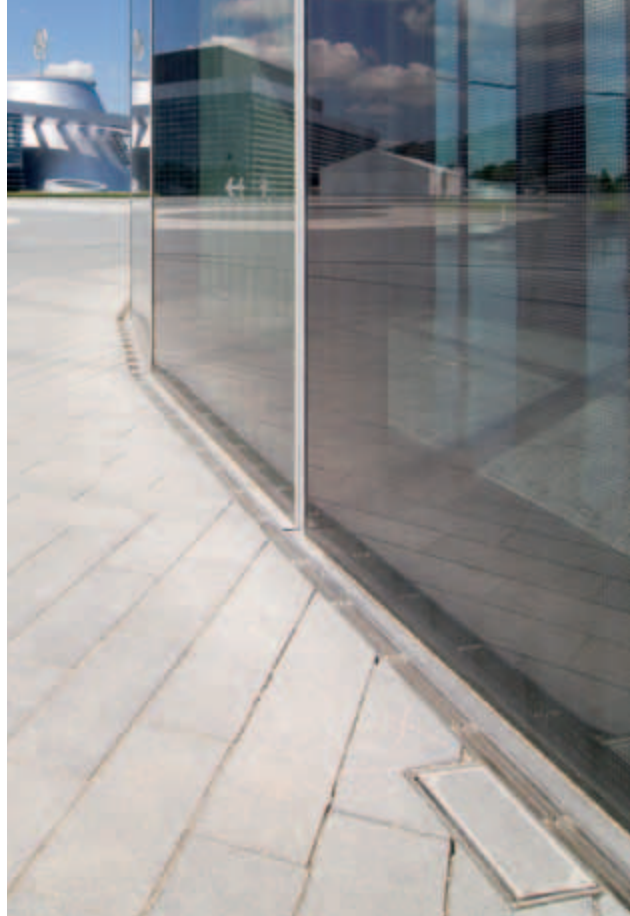
Voda stékající z fasád je sbírána do žlabů s podélnou štěrbínou a odnímatelnými bočními stěnami. Unikátní revizní kusy umožňují přístup do žlabů pro potřeby údržby.
